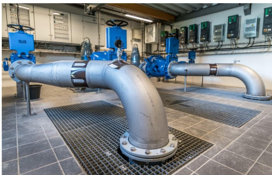
Nye returslumpumper til procestanken med tilhørende styring og frekvensomformere.
